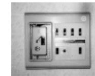
電気のブレーカー Power circuit breaker
